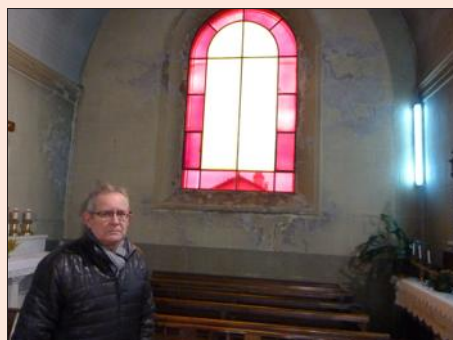
■ Edouard Pazdzior montre la dégradation d'une façade intérieure. Photo René MOUNIER
